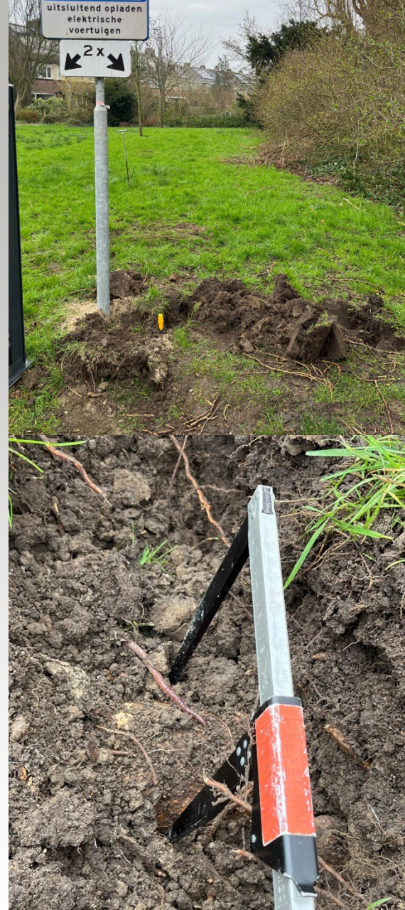
Uitwerking trafo Lekstraat
